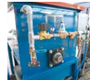
散水仕様 (タイマー自動開閉式) さらにタイマーで自動停止させるとボタン一つで誰でも安定した必要量を散水出来ます。
